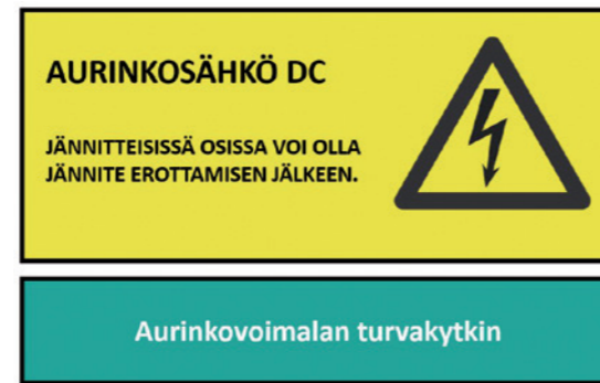
Kuva 3. Kenttäkoteloiden tai turvakytkimien merkintä katolla.
